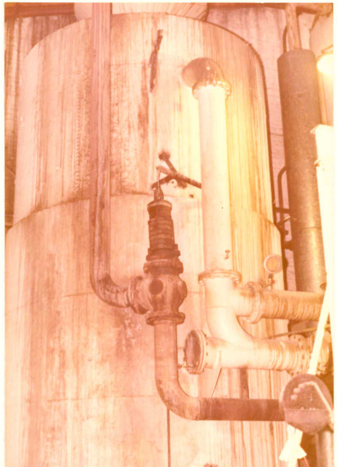
Chaudières de première et seconde carbona- tation
