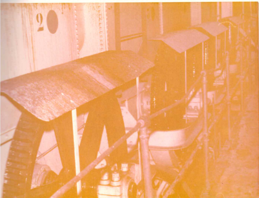
Batterie de malaxeurs
